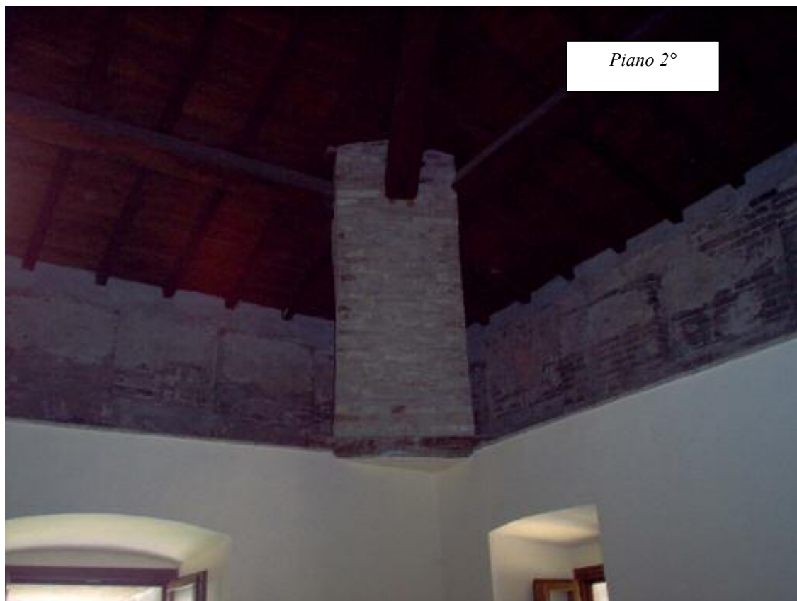
Foto 1.7.05 Torrione Medievale in Todi, Via A. Menecali, n°.4 piano 1 e 2 locali uso uffici
